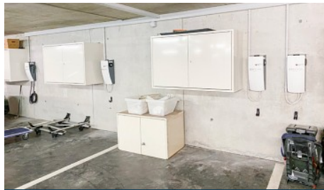
Ladestationen in der Tiefgarage Eichtalbohle 1a bis 5h
